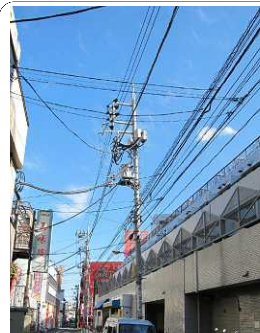
結局、電柱に設置している設備の不具合だったようです。
