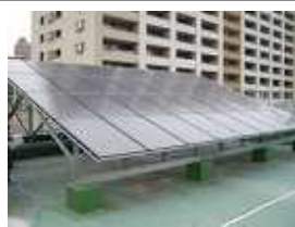
七峡小屋上のソーラーパネル(上)
