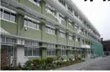
6年前に外壁改修した七峡小
